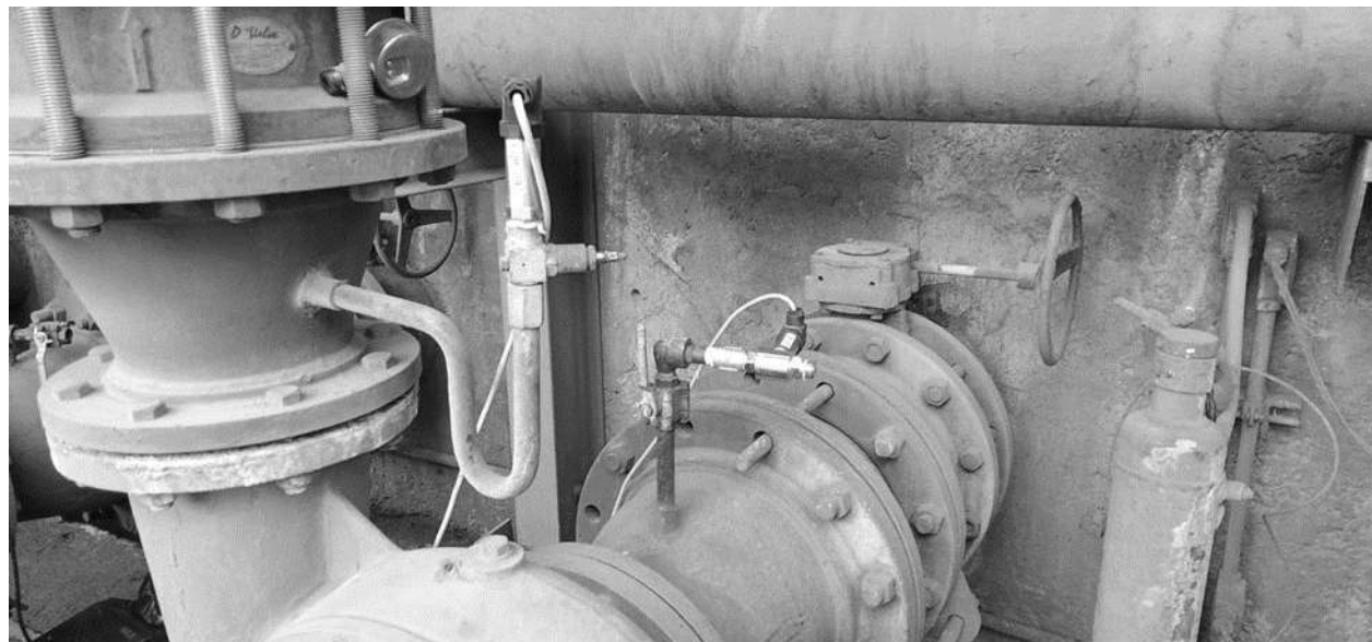
Figura 14. Transductores de presión manométrica en descarga y succión de una bomba.
