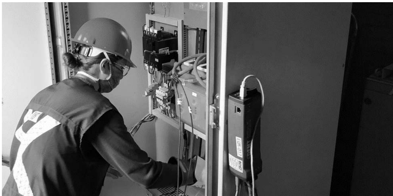
Figura 18. Auditora de energía realizando medición eléctrica de una unidad de bombeo con un medidor eléctrico trifásico DENT ELITE PRO XC.
