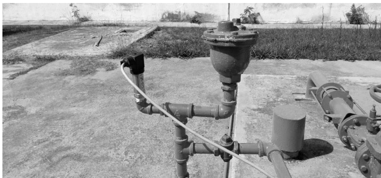
Figura 15. Medición de presión en el cabezal principal de descarga de varias bombas en paralelo.
