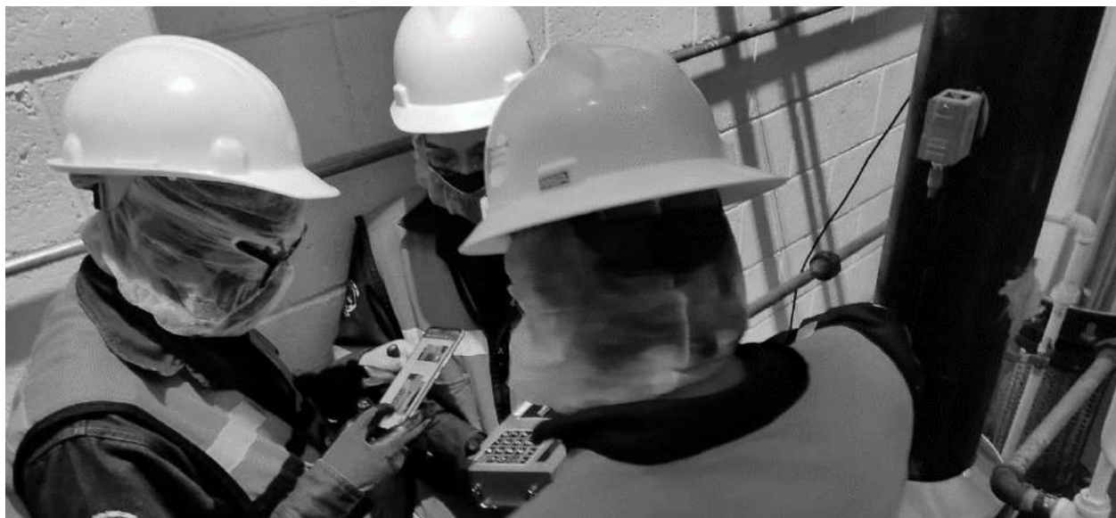
Figura 11. Configuración de medidor de caudal con ultrasonido.
